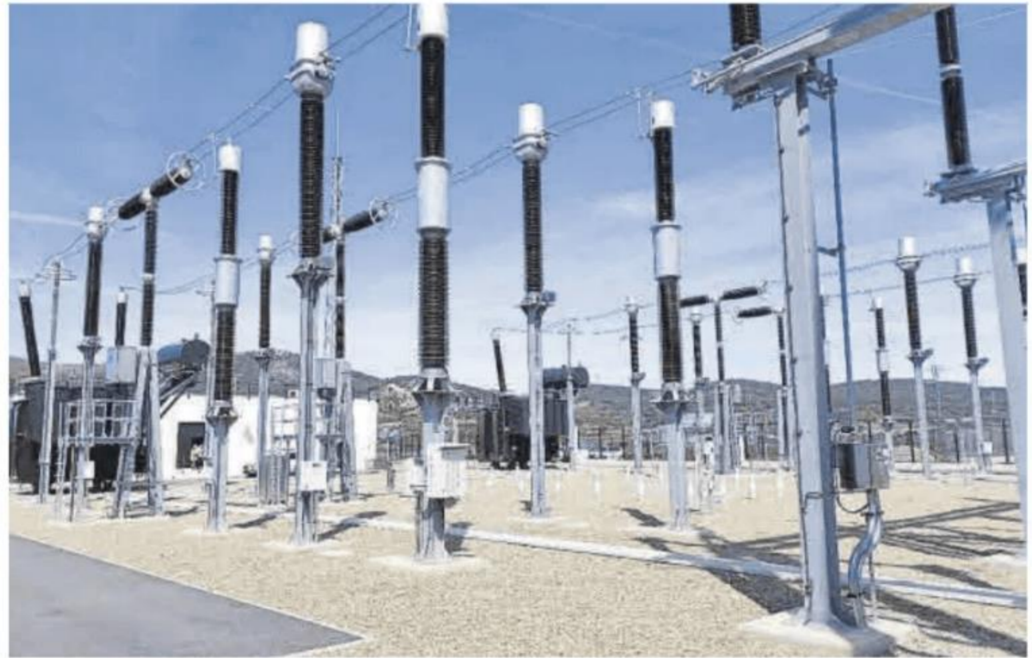
Subestación de Cañaverál, en el tramo Plasencia-Badajoz, similar a la que ahora se proyecta.
